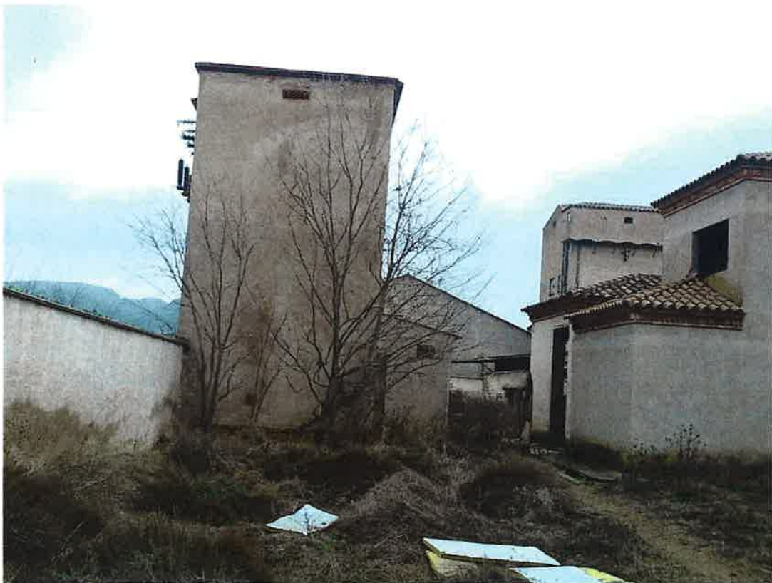
Exterior Centre Transformació
