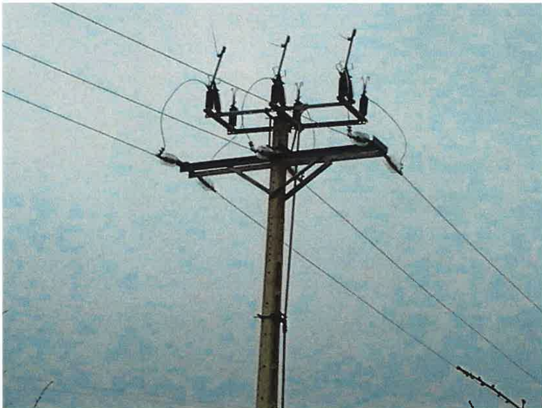
Seccionador Companyia Endesa Distribución Eléctrica, SL
