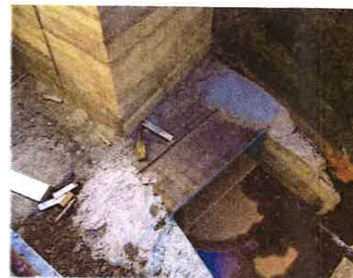
Salida de la aspiración una vez finalizada la obra civil y antes de su puesta en marcha.
